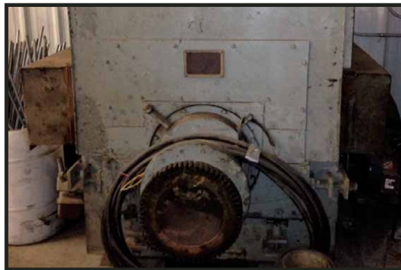
SIEMENS 1500 HP SHREDDER MOTOR
