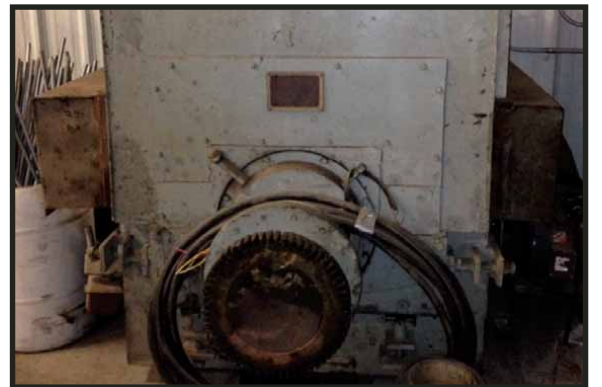
SIEMENS 1500 HP SHREDDER MOTOR
