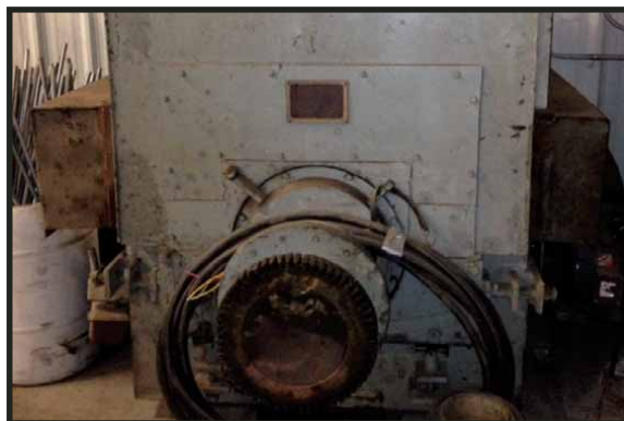
SIEMENS 1500 HP SHREDDER MOTOR
